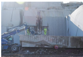
Perforación do bloque secundario con perforadora hidráulica para a elaboración de bloques menores
