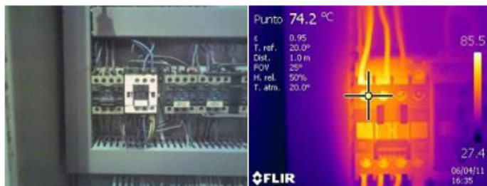
Detección de punto quente en cadro eléctrico mediante cámara termográfica
