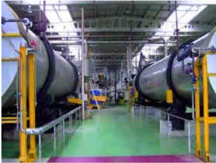
Instalación para a cocción de residuos
