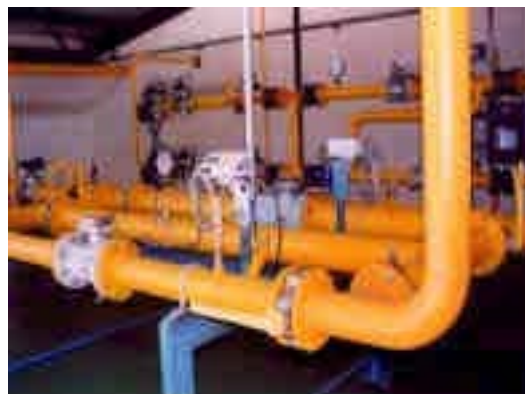
Estación de regulación e medida
