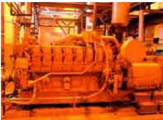
Motores de coxeración a gas natural
