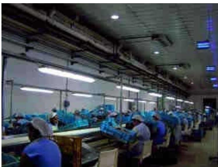
Zona iluminada localmente con pantallas de tubos fluorescentes
