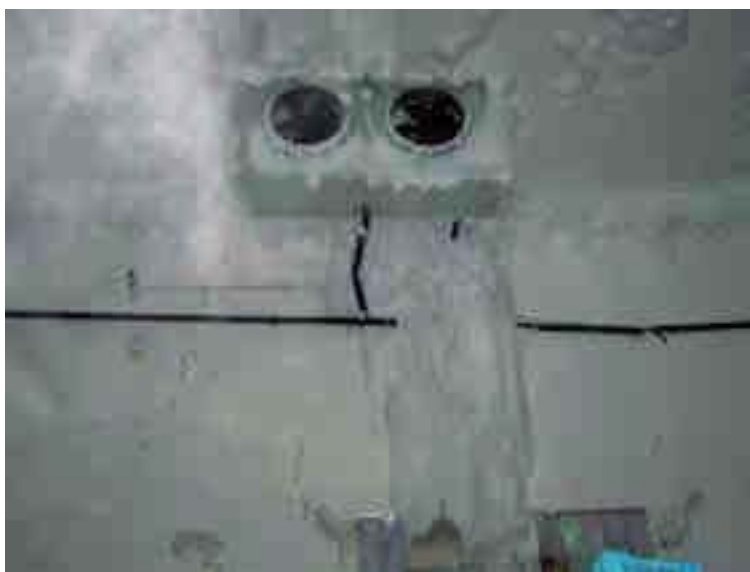
Acumulación de xeo no teito dunha cámara de conxelación
